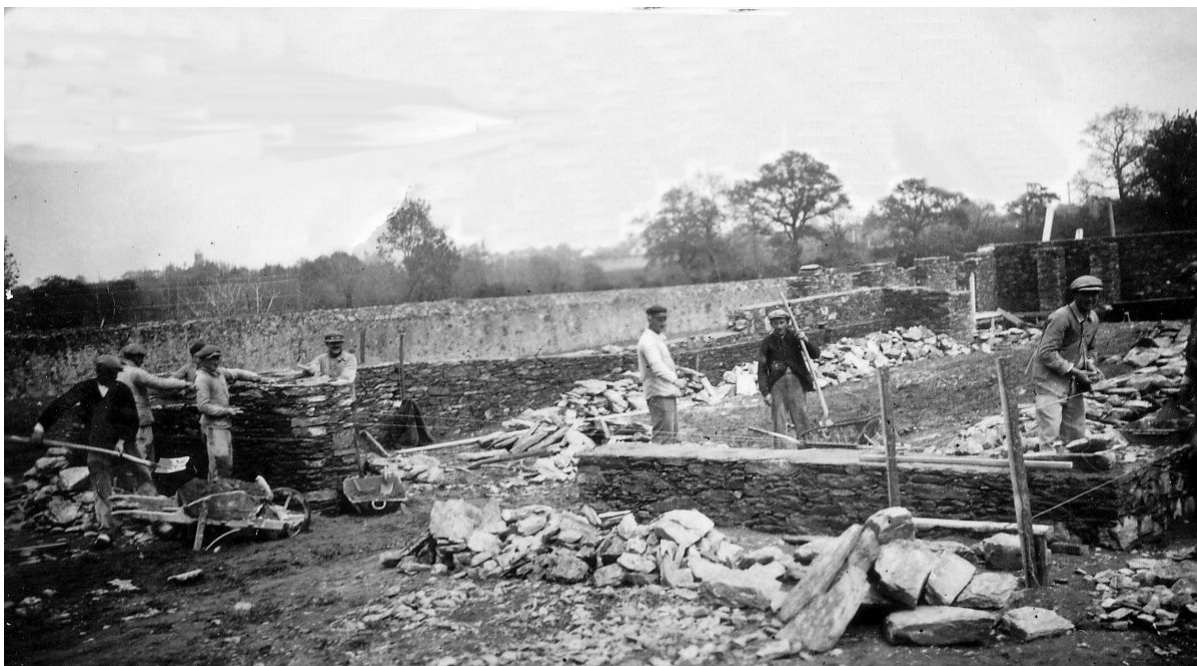
Sur le chantier de la salle Saint-Roch en 1936 (coll. M. Landry) De gauche à droite : Louis Barteau père, Albert Landry, Coco Landry, Eugène Jahan, Ernest Rondineau, Albert Renaudin, Arthur Mainguy, Francis Bourreau.
